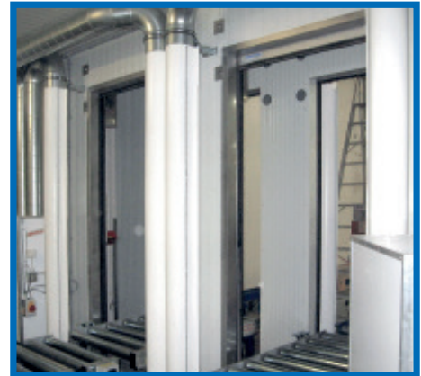
Tiefkühl-Tor zum inertisierten Bereich
